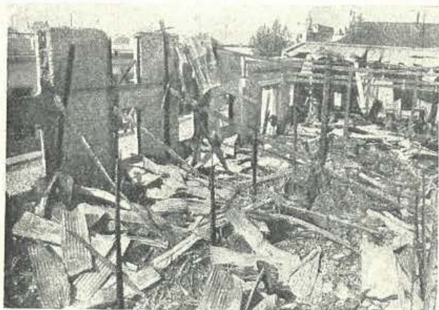
El interior de la licorería de la calle Municipio, 51, después del incendio que la consumió
